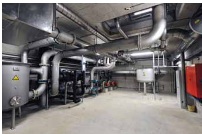
Installationen im Gasraum
