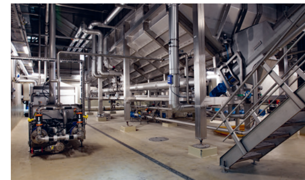
Dezember 2019, die Aufbereitungsanlage ist installiert.
